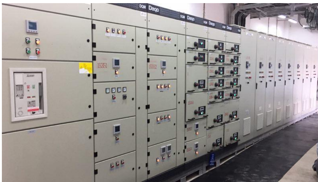
图 1 水泥生产线原料磨电力室现场照片
